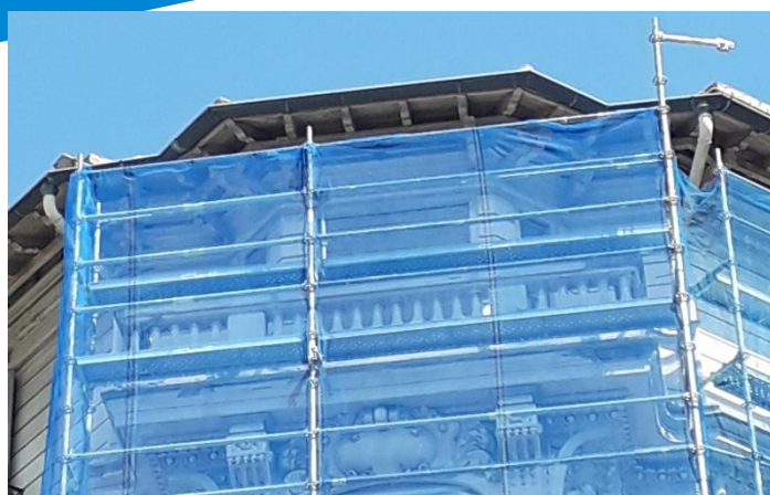
Echafaudages bloquant l'accès au site de nidification © Anne FALENTIN
